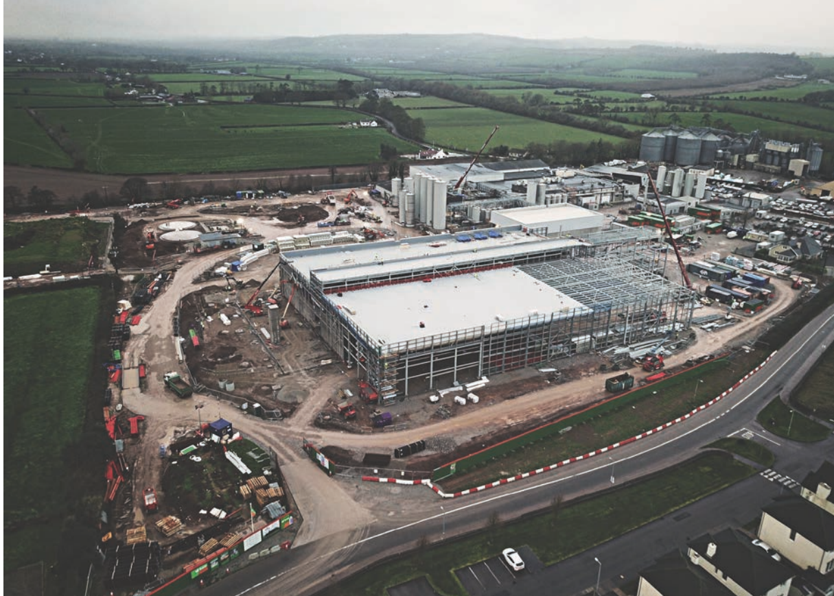
Produksjonsanlegg for Jarlsberg® i Irland. Den første melka skal inn i anlegget i oktober 2019.
